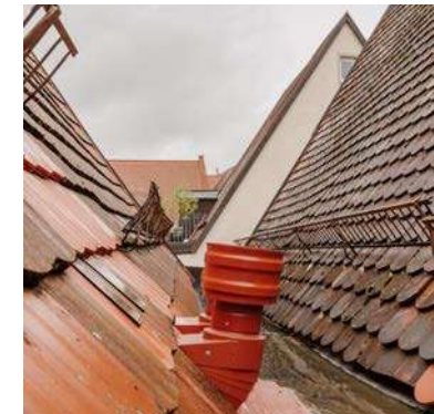
Technik dezent gelöst: Fortluftauslass der Wärmepumpe auf dem Dach – unsichtbar im Stadtbild.
